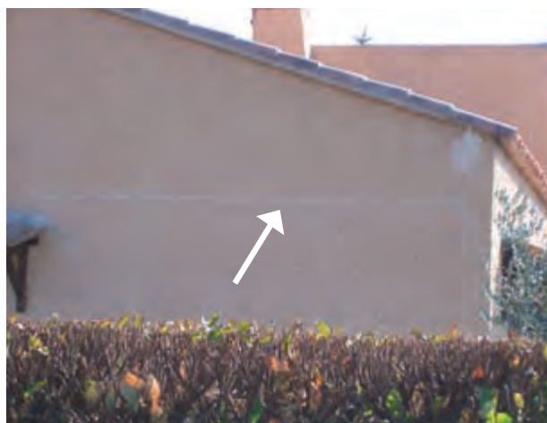
Fissuration traduisant un décollement de la structure par absence de liaisonnement entre niveau bas et combles.
